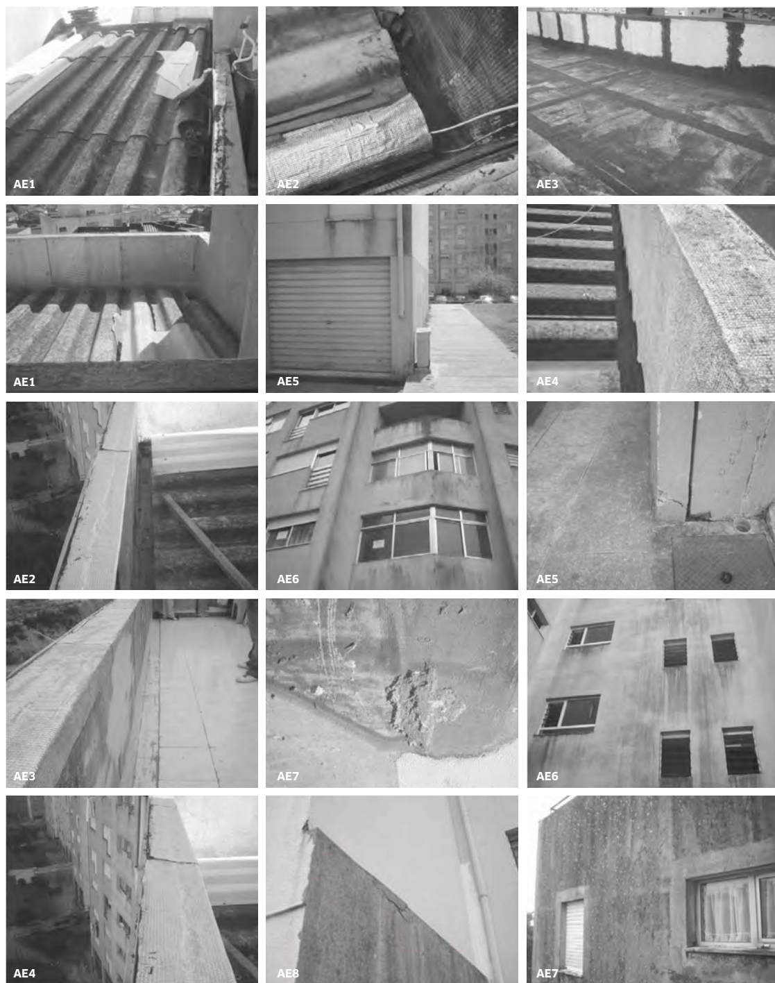
Fig. 3 Anomalías exteriores observadas
