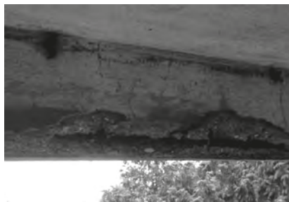
Delaminação do betão na zona da escada
