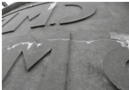
Fissuras horizontais na face exterior do reservatório
