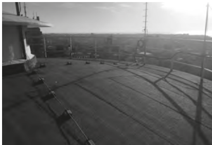
Sistema de impermeabilização da Torre de Pressão
