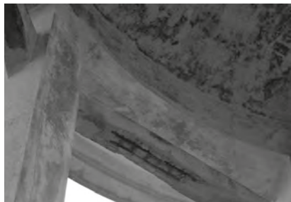
Armaduras à vista nas vigas de travamento e cintagem
