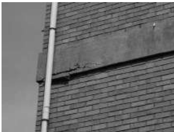
Fig. 04. Estado inicial - patologias em betão aparente
