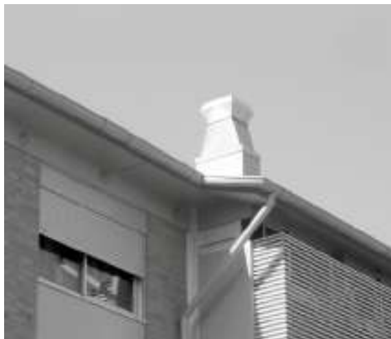
Fig. 16. Sistema de ventilação mecânico, antes e depois
